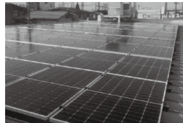
▲事務所の屋上に設置している太陽光パネル
